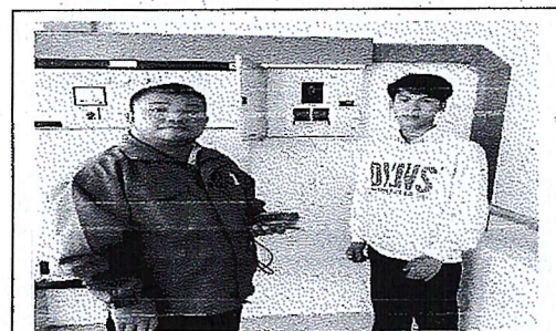
(ตรวจเช็คระบบไฟฟ้าภายในอาคารเรียน )
